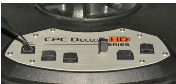
Abdeckkappen verhindern, dass Feuchtigkeit in unbelegte Buchsen gelangen kann oder Kabel falsch angeschlossen werden und zu Kurzschlüssen führen.
